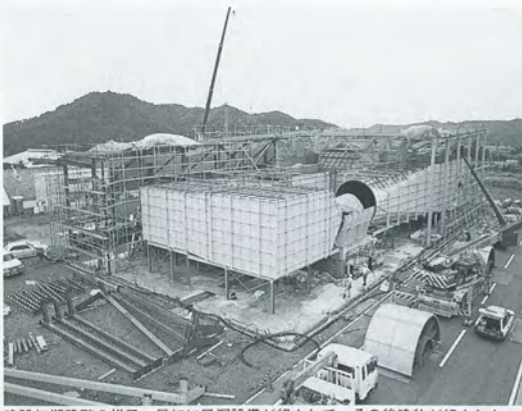
建設初期段階の様子。最初に風洞設備が組み立てられ、その後建物が組み立てられた
