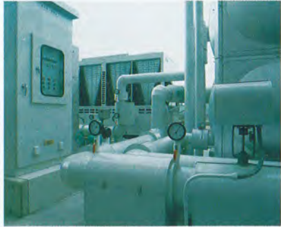
外部に設置される冷却水のプラント。夜間に冷水を作っておくことで、1年中内部の温度を一定に保つことができる
